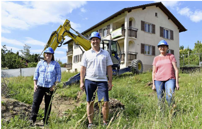
Zufriedene Gesichter am gestrigen Spatenstich (v. l.): Daniela Zysset, Präsidentin der Wohnbaugenossenschaft Bürg, Architekt Dominic Nussbaum und WBG-Vorstandsmitglied Therese Sieber. Foto: Jürg Spielmann
